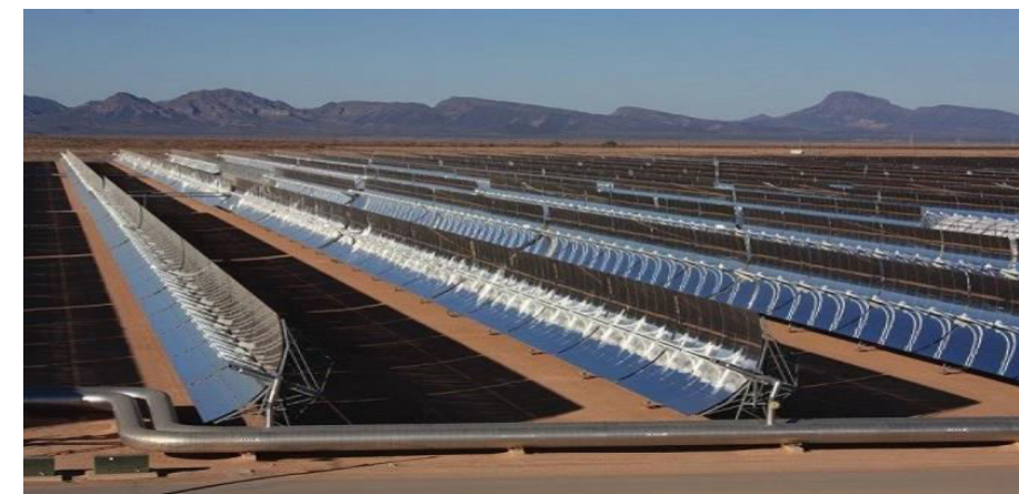
Solarna elektrana (California, USA) 12
