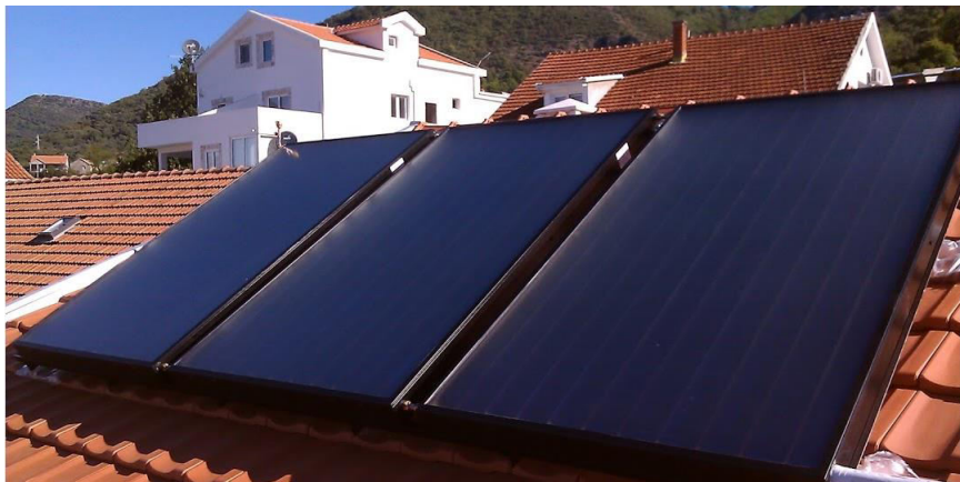
Solarni termalni kolektori
